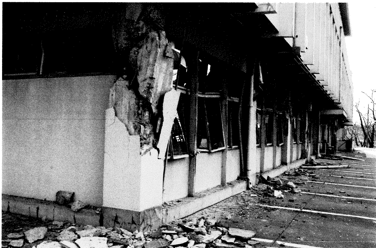
使用できなくなった旧笠間市役所本庁舎。新庁舎建設が進んでいる。県内では多くの自治体で庁舎が使用できなくなり、建替えのための財源の捻出に頭を悩ませている。
