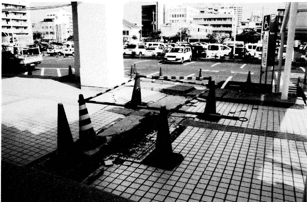
使用ができなくなった7階建ての水戸市役所本庁舎玄関口。現在は駐車場にプレハブの臨時庁舎が並ぶ。今後については巨額の財源の手当てを含め検討中。
